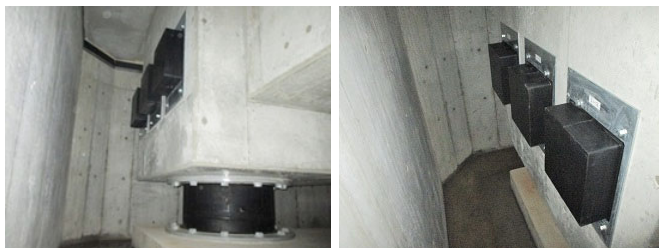
写真1 免震フェンダーの設置状況例
