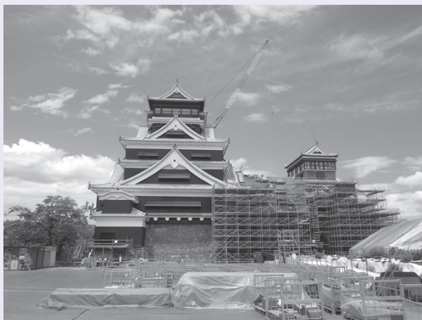
熊本城(提供:熊本城総合事務所)
