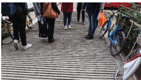
古い理念と技術ではニーズに対応できない 路面が滑らぬよう洗濯板状に処理したが、車椅子使用者や高齢者の通行には不適切で、転ぶ危険性さえある。
