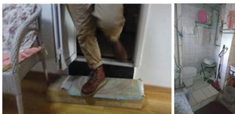
住戸内に段差あり、特に浴室トイレ付近 段差付近には常に設備配管と構造の問題があるため、改修が難しい。
