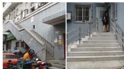
住宅棟入口に昇降補助措置がない 建設当時、コスト問題等でエレベータ未設計。半地下室の採光のため一階の床を高した結果、入口の段差が大きくなり、しかもスロープ未設計。
