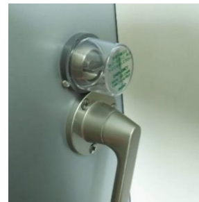
非常口のドアに設置されたサムターンカバーの例
